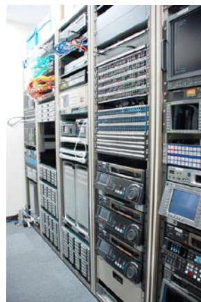
1 階マシンルームの VTR 群と Xsan サーバー
